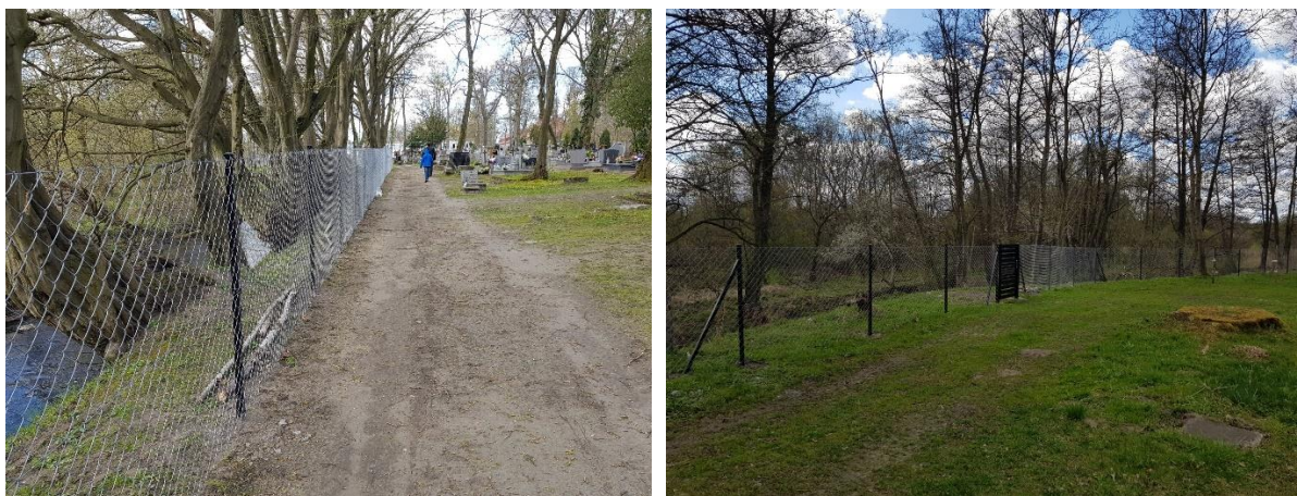
Zdjęcia: Nowo wybudowane ogrodzenie cmentarza komunalnego przy ul. Szpitalnej (źródło: zasoby Wydziału Przedsiębiorczości i Funduszy Zewnętrznych UM)
